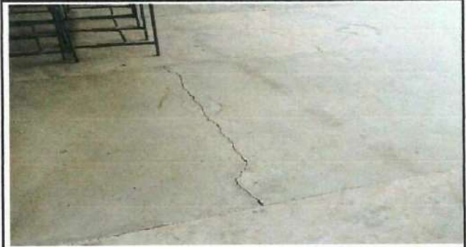
Foto 2: Sustrucion del piso de torta de cemento el cual se Observa en deterioro.
