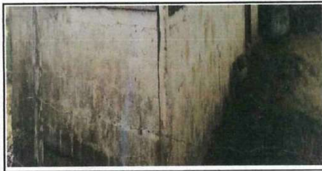
Foto 5: Mantenimieneto de pared en mal estado.
